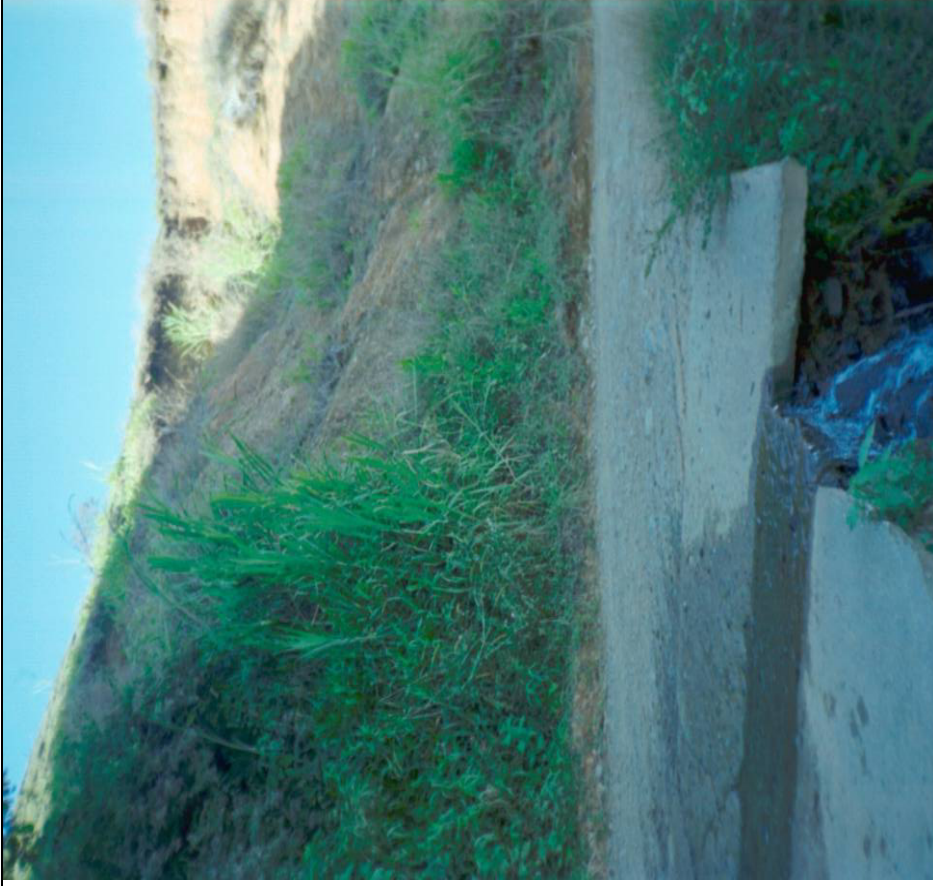
Photo 4.7: Erdrutsch im Sektor Sacatin . An der Ausfallstraße Quebradona- Jericó sind Straßenschäden entstanden. Aufn. M. Zuleta vom 10.2003 in 1700 m.ü.d.M.
